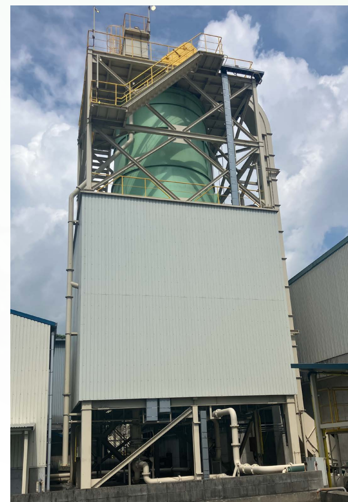
新設した破砕後廃プラスチック貯蔵サイロ（赤穂工場）
