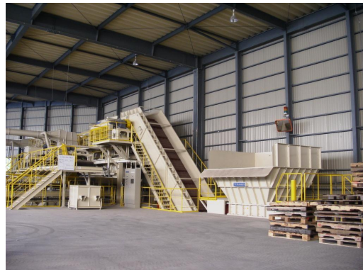
泉工業燃料化設備
