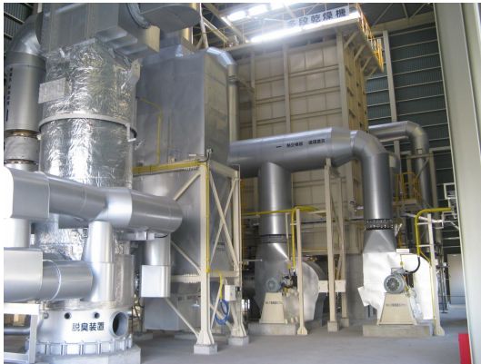
(乾燥・燃料化設備)
