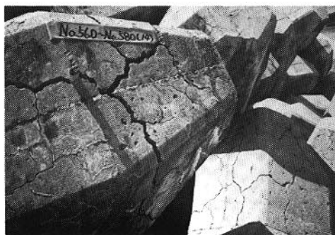
写真3 海岸の消波ブロックの大きなひびわれ
