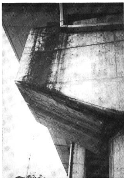
写真2 高架線の橋脚の水の流れる部分のみのひびわれ
