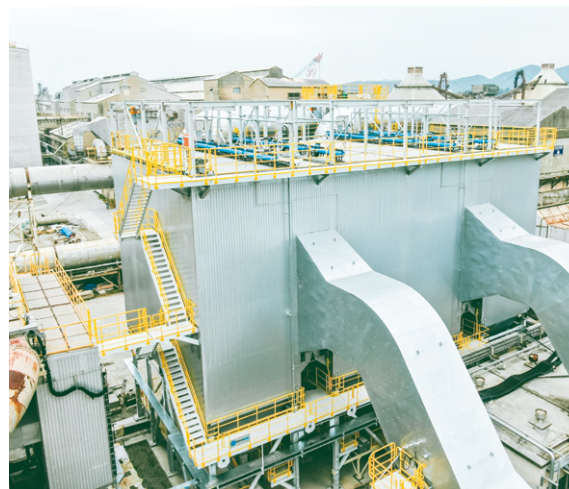
赤穂工場バグフィルター集塵機
