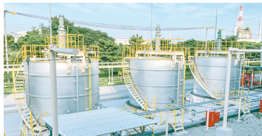
増設した廃油タンク(赤穂工場)
