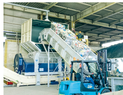
新設した廃プラスチック破砕機(赤穂工場)
