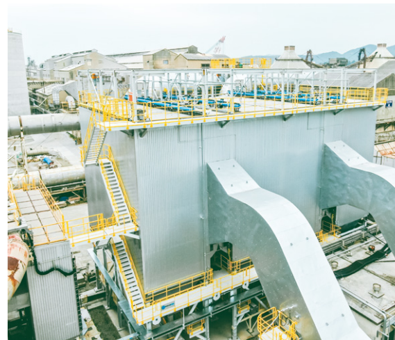
赤穂工場バグフィルター集塵機
