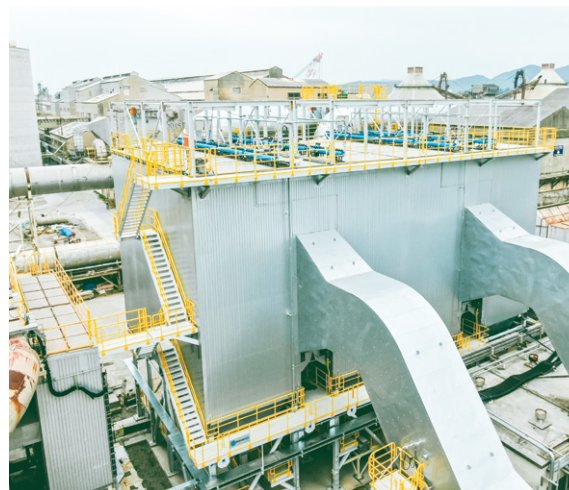
赤穂工場バグフィルター集塵機
