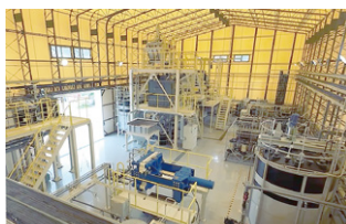
栃木工場敷地内人工石灰石パイロットスケール製造試験設備の外観(上)/内観(下)
