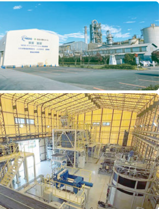
栃木工場敷地内CO 2 再資源化人工石灰石パイロットスケール製造試験設備の外観・内観
