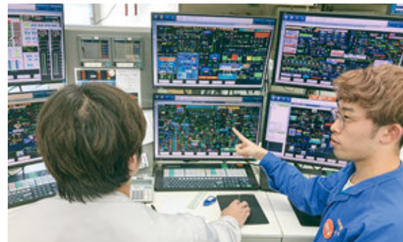
リニューアルした中央操作室で打ち合わせをしている様子
