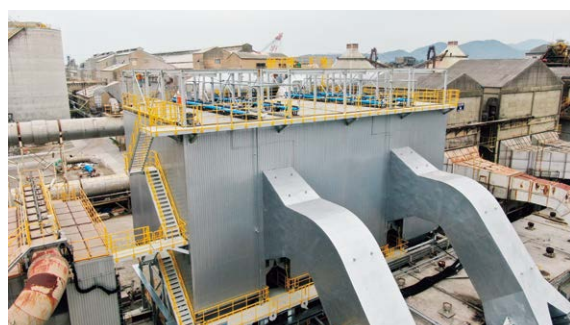
赤穂工場 電気集塵機から切り替えたバグフィルター
