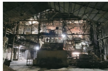
LED照明に変更したNo.3K設備
