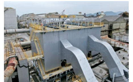
赤穂工場 電気集塵機のバグフィルター化
