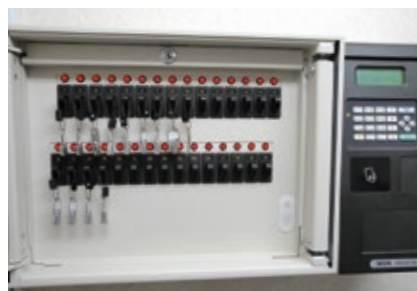
セメント・コンクリート研究所 薬品庫鍵管理ボックス
