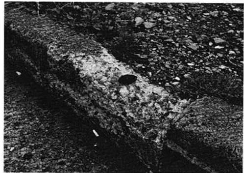
写真1 凍結融解による劣化事例 (コンクリート研究室 片山参事 提供) (現:セメント化学研究室)
